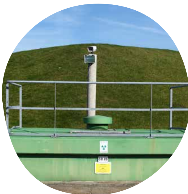
Chambre de collecte des eaux de drainage
