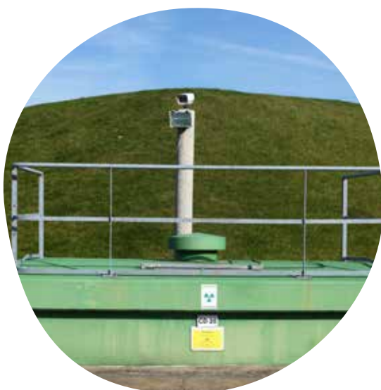
Chambre de collecte des eaux de drainage
